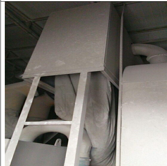
搅拌站主机布袋除尘
