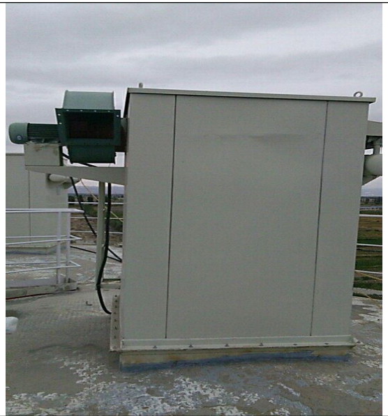
仓筒顶部布袋除尘 3
