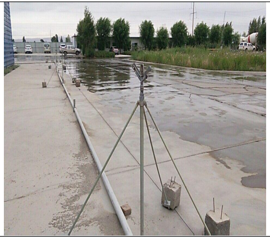
喷洒降尘装置
