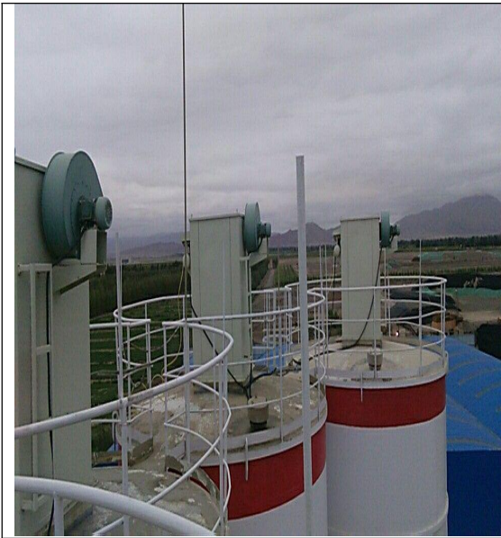
仓筒顶部布袋除尘 2
