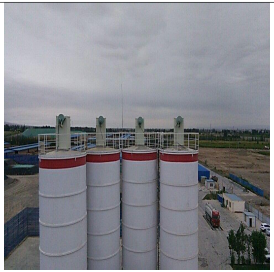
仓筒顶部布袋除尘1
